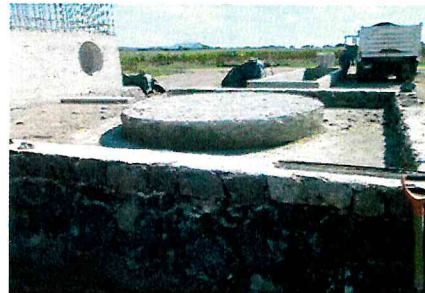
CONSTRUCCIÓN DE RED DE DRENAJE SANITARIO Y PLANTA DE TRATAMIENTO EN LA COMUNIDAD DE CUCHICUATO (1RA ETAPA).
