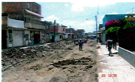
CALLE: ROBERTO FIERRO TRAMO: C. PROGRESO A J. J. TORRES LANDA COLONIA: RODRÍGUEZ
